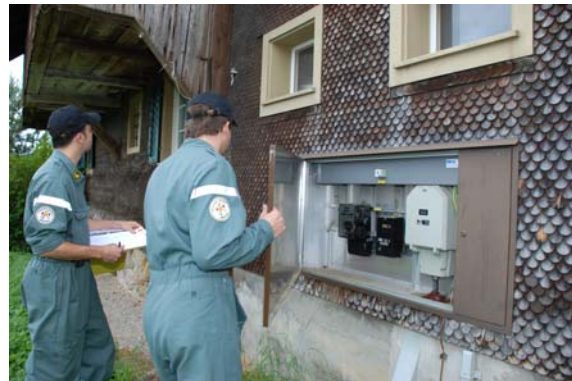
Häufigster Schaltpunkt im Ereignisfall: Der Aussenkasten.
